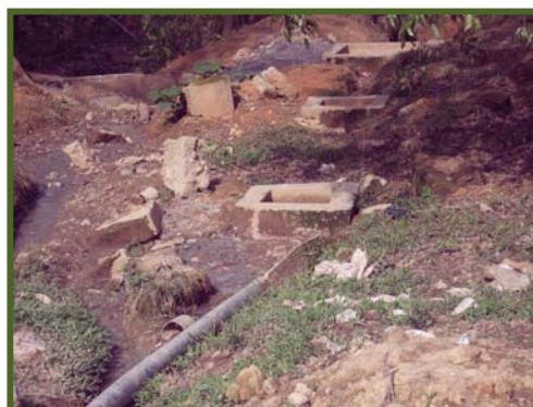
Foto 8. Sistema de tratamiento colapsado totalmente. Centro Humboldt, mayo 2009.
