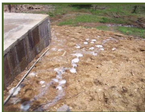
Foto 7. Sumidero sobre saturado y drenando superficialmente hacia un cauce. Centro Humboldt, mayo 2009.
